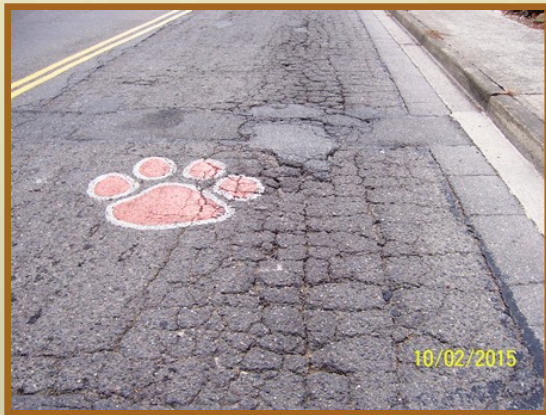
Deteriorating asphalt— Johnson Rd.
